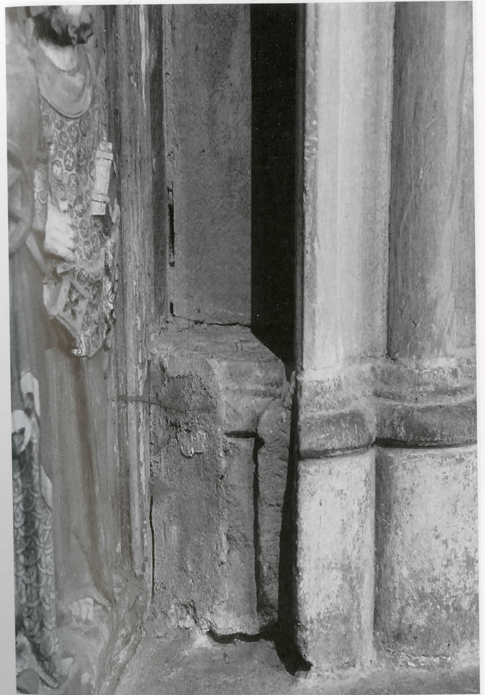
Abb. 20 Mausoleum, Abarbeitungsspuren an der Baldachinarchitektur
